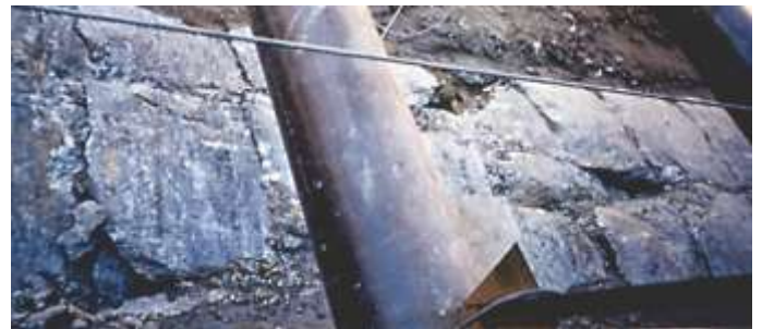
Fig. 4.5. Vista del extradós del conducto. Se aprecian las fracturas longitudinales y las juntas transversales.
