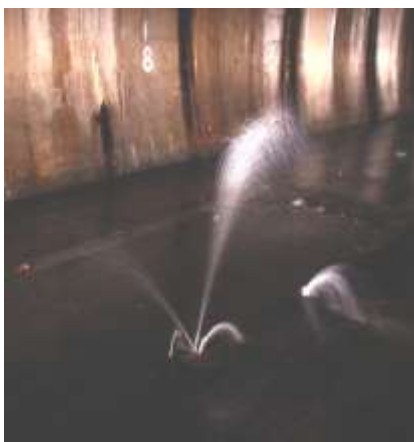
Fig. 3.3. Ingreso de agua a través de orificios practicados en la solera del túnel mapeado en la Fig. 3.2.
